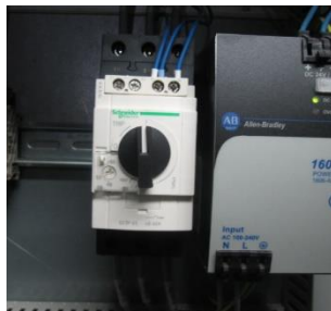
Magnetotérmico cerrado, en condiciones de servicio/Circuit breaker in operation condition.
