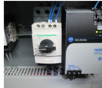
Magnetotérmico abierto/Circuit breaker opens.
